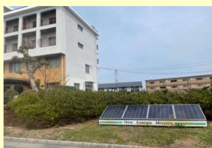
太陽光発電施設の設置・展示
