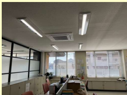
事務所内照明の LED 化
